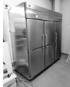
新設した大型冷凍庫
